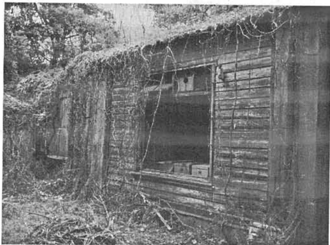
今にも崩れそうな乾燥室
